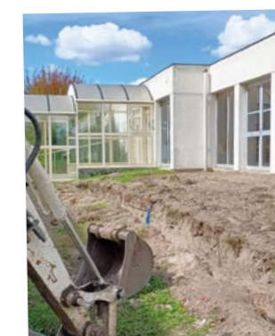
Aménagement d'une terrasse entre la salle des fêtes et le Hall d'accueil
