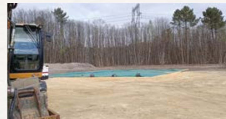
Avec cette nouvelle bâche, Bourgueil compte maintenant 7 réservoirs répartis sur le massif forestier de la commune.
